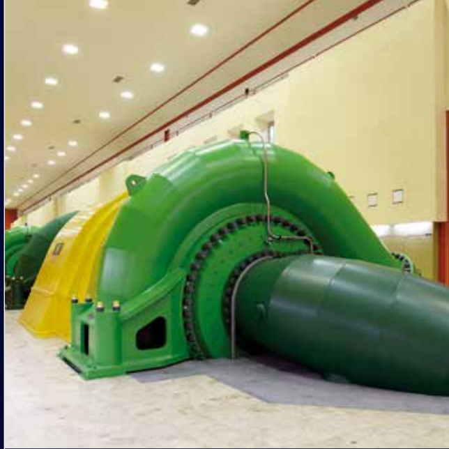
Grimsel 2, une des plus grandes centrale de pompage-turbinage de Suisse
